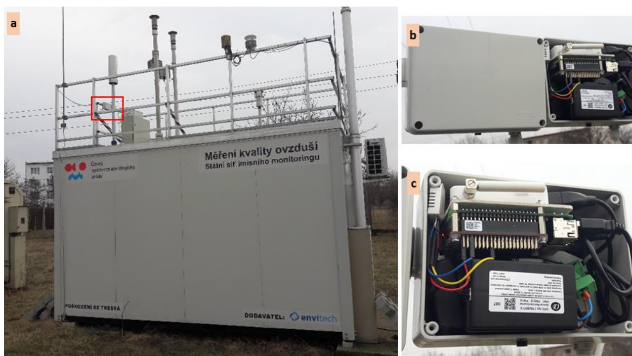
Obr. č. 21. Párová sada prachoměrů Alphasense OPC-N2 (c) instalovaná v průvzdušném boxu (b) umístěném na střeše referenční stanice AIM na Observatoři v Tušimicích (a). Foto: P. Bauerová
