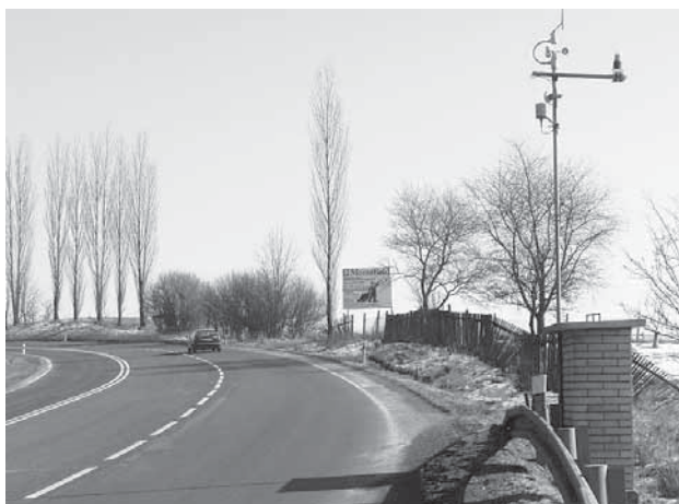
Obr. 2 Silniční meteorologická stanice technologie Lufft instalovaná většinou na silnicích 1. a 2. třídy.
